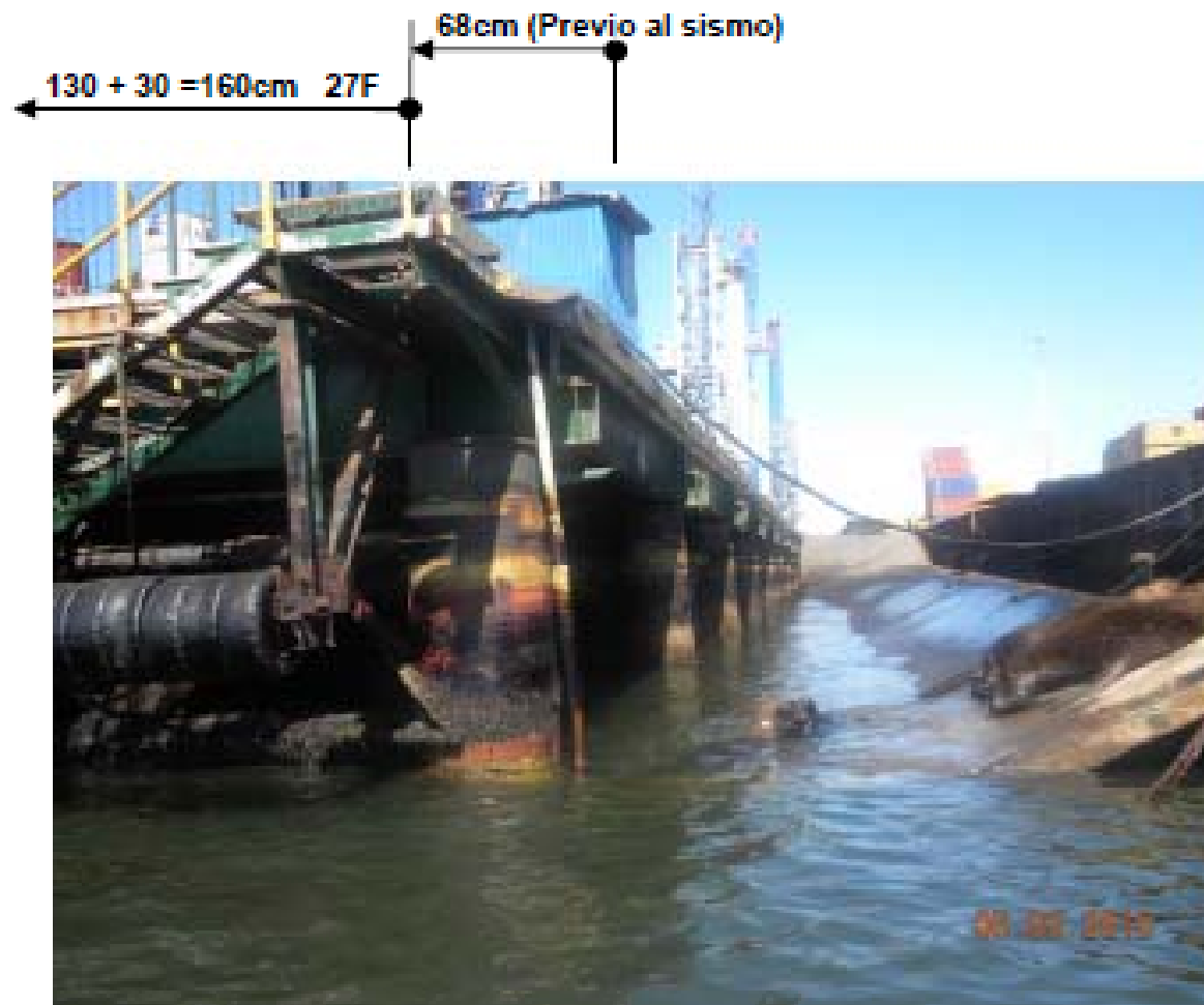
FIG.7 EFECTO DEL DESPLAZAMIENTO DEBIDO AL SISMO 27F EN EL SITIO CERO
